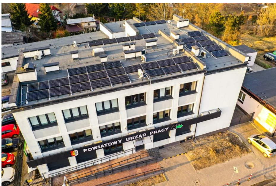
Fotografia 17 Instalacja fotowoltaiczna wykonana na budynku Powiatowego Urzędu Pracy we Włocławku.
